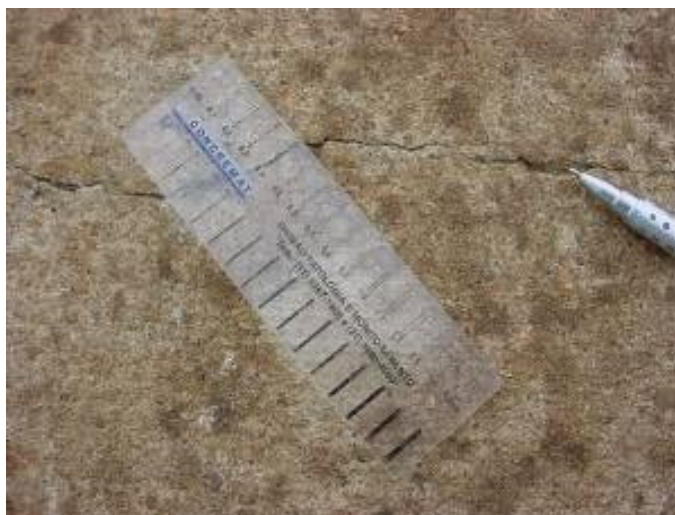
Figura 4 – medição de fissuras (Autores do trabalho 2015).
