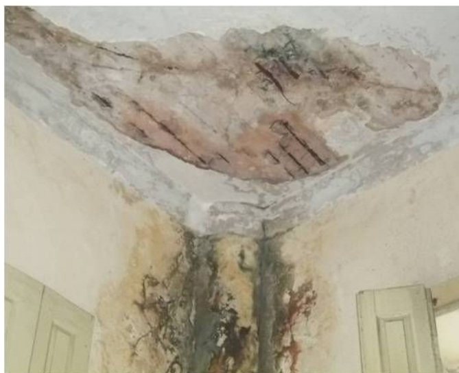
Figura 5. Mostra laje com ferragem totalmente exposta, com processo de carbonatação do concreto (Disponível em: http://www.sinpol-ma.com.br/textos_11/texto241011_3.html . Acessado em 20/11/2013)
