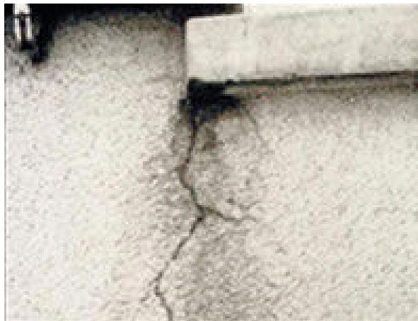
Figura 8. Acúmulo de água em borda de peitoril provoca rachaduras e formação de fungos(Disponível em: http://techne.pini.com.br/engenharia-civil/137/beirada-seca-pingadeira-e-opcao-mais-eficiente-para-afastar-286530-1.aspx . Acessado em 20/11/2013)
