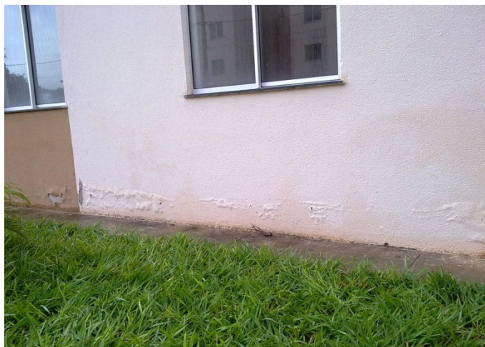
Figura 6. Infiltração por capilaridade (Disponível em: http://drparede.blogspot.com.br/2011/12/patologias-em-paredes-i-infiltracao-por.html . Acessado em 20/11/2013)
