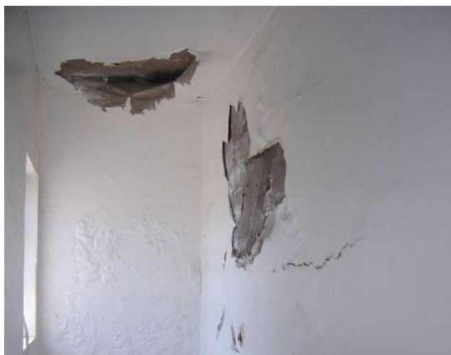
Figura 7. O reservatório apresentava avançados problemas de infiltração em sua laje de base (RIGUI, 2009)
