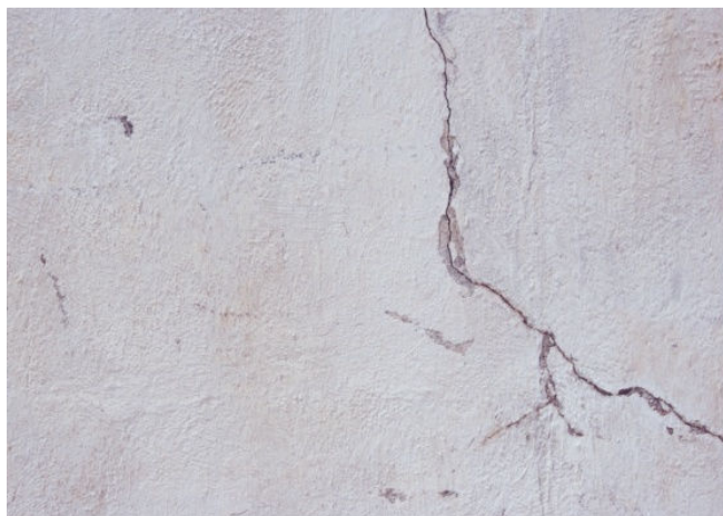
Figura 4. Trincas em fachada (Disponível em: http://www.sindicond.com.br/noticia/2125-Como-lidar-com-trincas-nas-edificacoes . Acessado em 20/11/2013)
