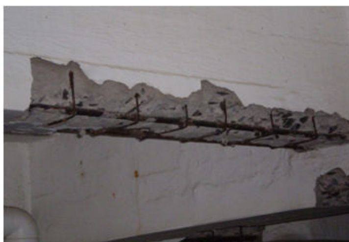
Figura 3. Deterioração de uma viga com armadura exposta (Disponível em: http://infrapesa.com.br/news.html . Acessado em 20/11/2013)
