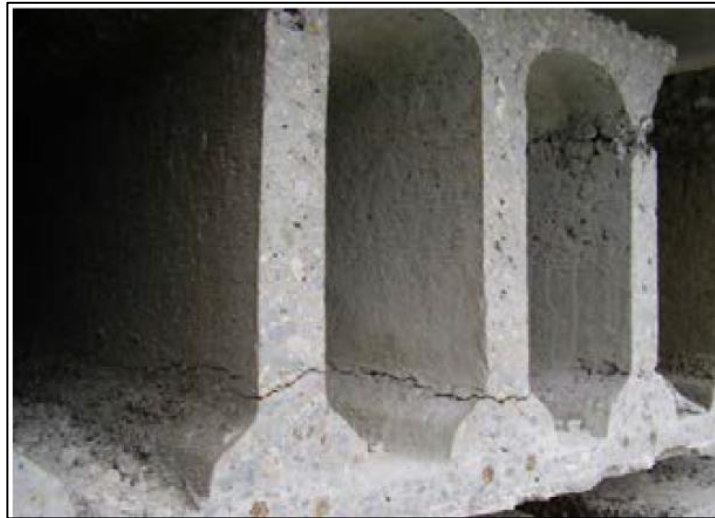
Figura 4 – Fissuras na ligação da alma com o talão inferior em laje alveolar. (DERKOWSKI e DYBA, 2017)
